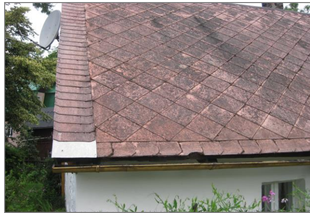
Fot. 2 Płyty azbestowo-cementowe płaskie
